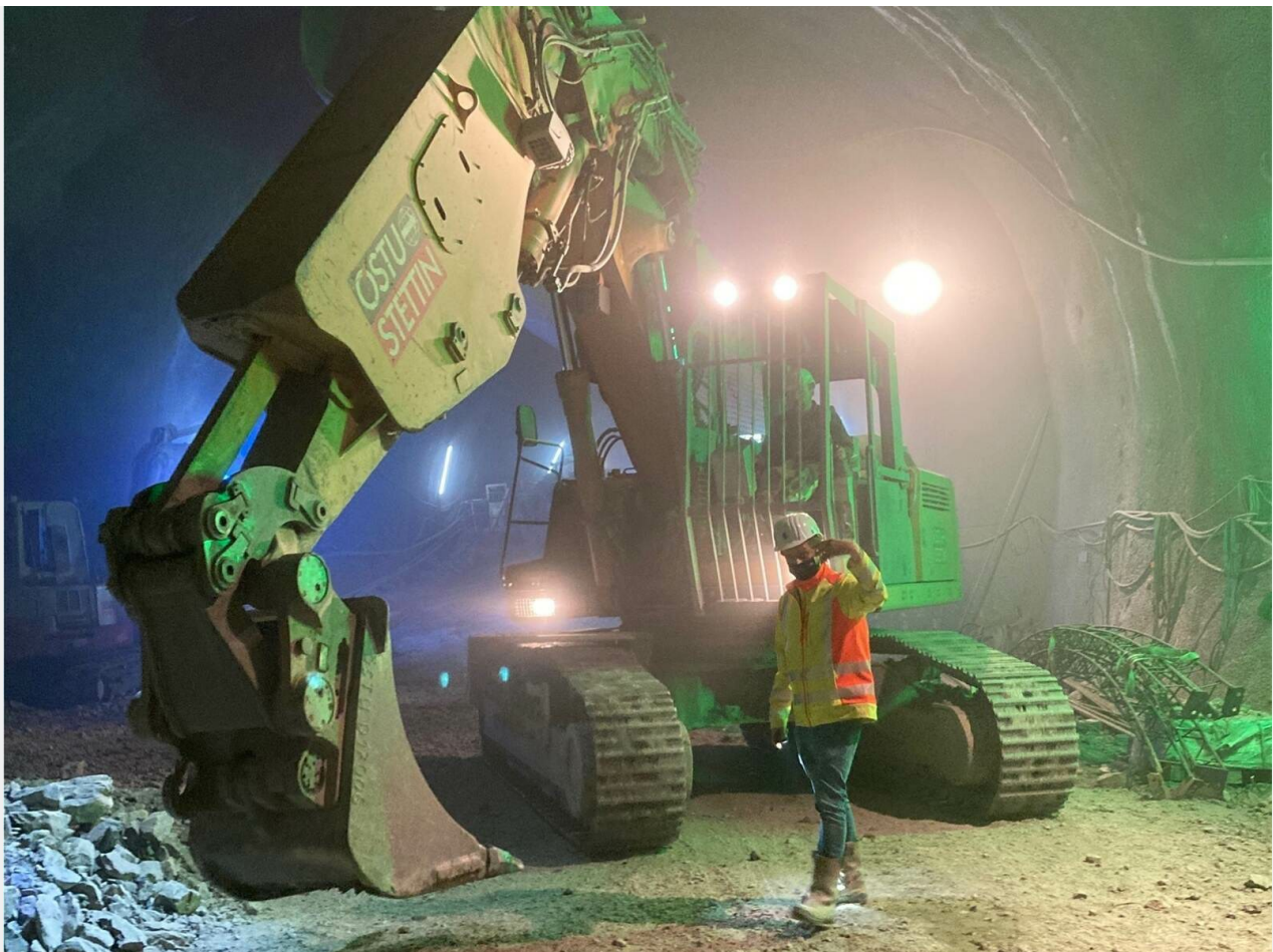
Zwölf Stunden am Stück malochen die Arbeiter im Tunnel – und das alles im Zwei-Schicht-Betrieb. Foto: Lorch-Gerstenmaier
